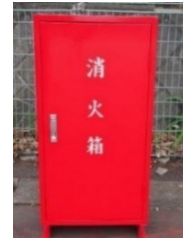
初期消火箱（固定式）
